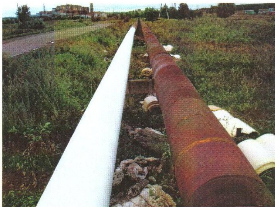
Фотография трубы с выполненной комбинированной теплоизоляцией (с лева) и традиционной изоляцией (справа).
